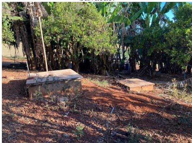
Figura 27: Sistema de tratamento de efluentes líquidos sanitários (fossa séptica) casa do caseiro e barracão.
