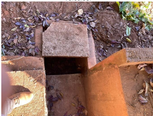
Figura 24: Sistema de tratamento do lavador de veículos.
