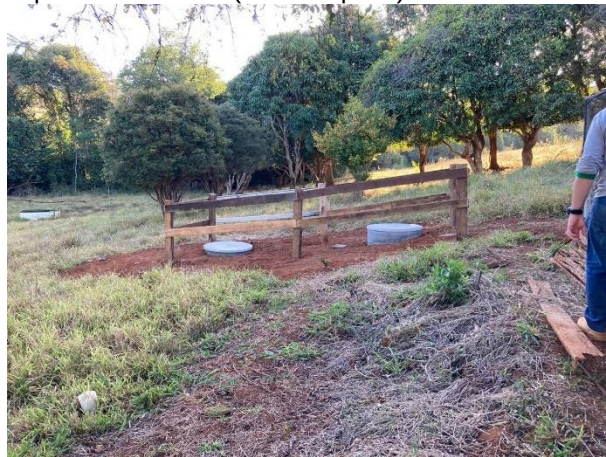
Figura 30: Sistema de tratamento de efluentes líquidos sanitários (fossa séptica) casa do caseiro.
