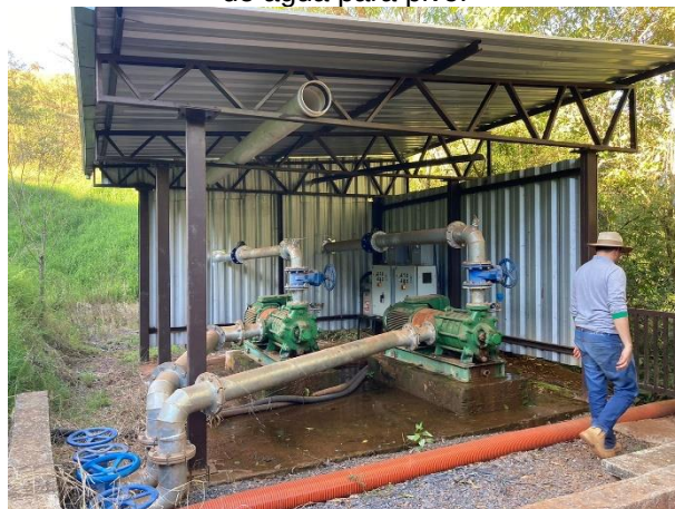
Figura 10: Vista da casa de bombas para captação de água para pivô.
