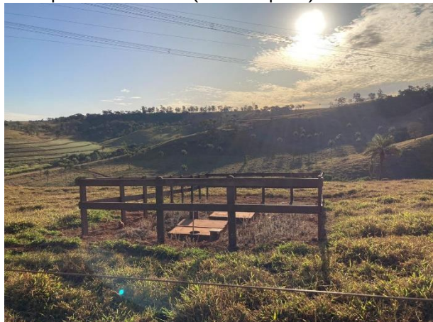
Figura 17: Sistema de tratamento de efluentes líquidos sanitários (fossa séptica) escritório.
