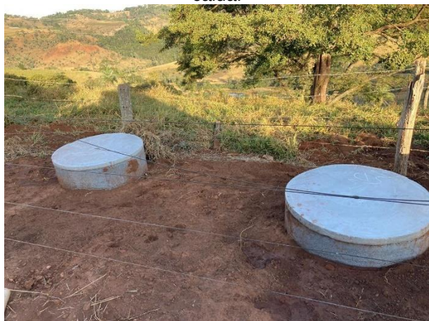
Figura 33: Sistema de tratamento de efluentes líquidos da pista de abastecimento e preparo de calda.
