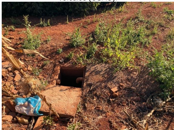
Figura 25: Sistema de tratamento do lavador de veículos (CSAO).
