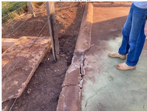
Figura 32: Estrutura da pista danificada observada em vistoria.
